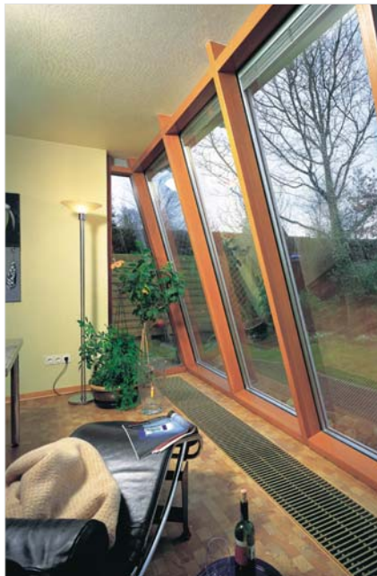
Bild 9: Gebläsekonvektoren (Bild: Firma EMCO)
