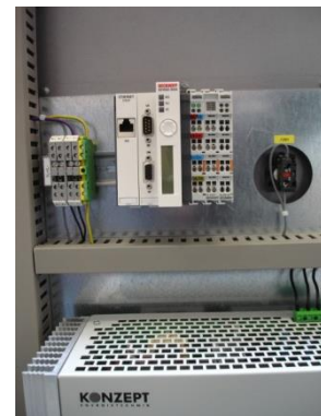
Abb. 3 Gateway in der Schaltschranktür des BHKW EM-238/363
