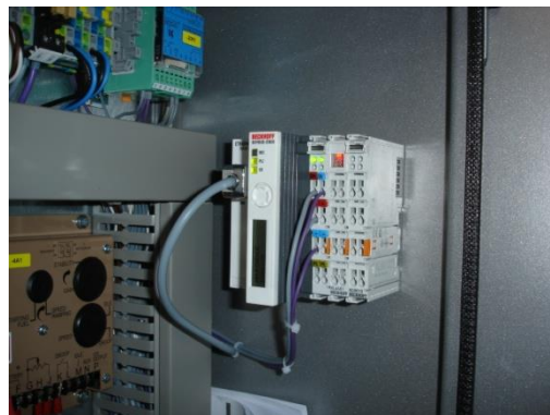
Abb. 2 Gateway an der Seitenwand des BHKW-Schaltschranks EM-140/207
