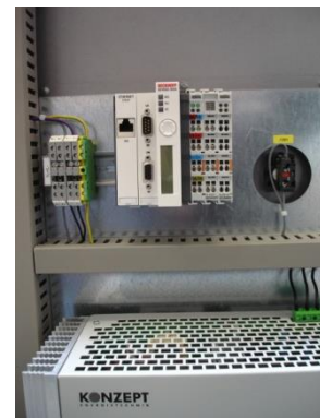
Abb. 3 Gateway in der Schaltschranktür des BHKW EM-238/363
